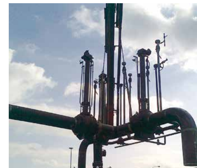
Línea de gas Gas pipeline
